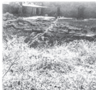
Muro perimetral derribado por el terremoto de 1976 en la sede de la Cooperativa (Cooperativa Chiquimuljá). 103
